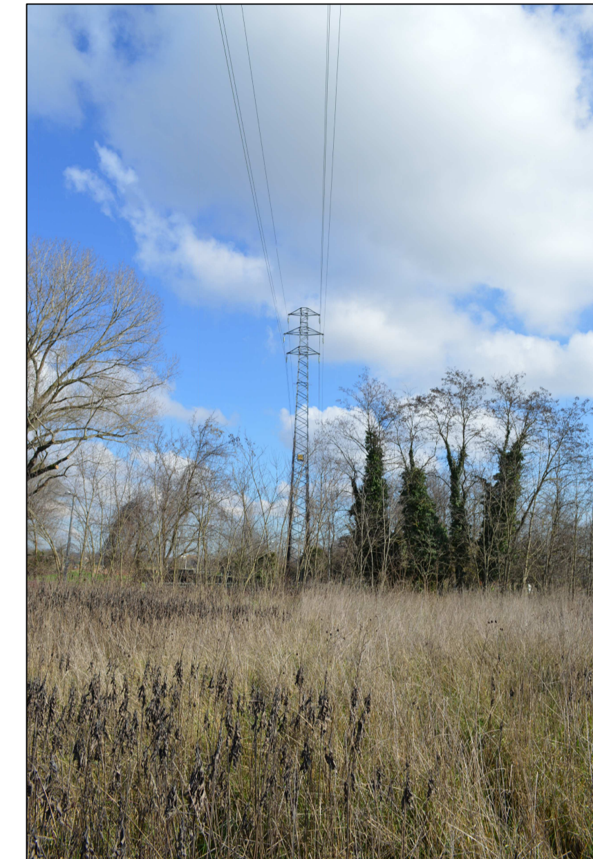
Foto 11: Angolo Nord-Est, traliccio a bassa tensione
