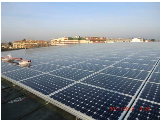
Foto impianto su tetto
