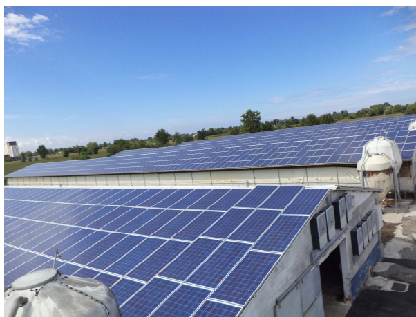
Foto impianto su tetto
