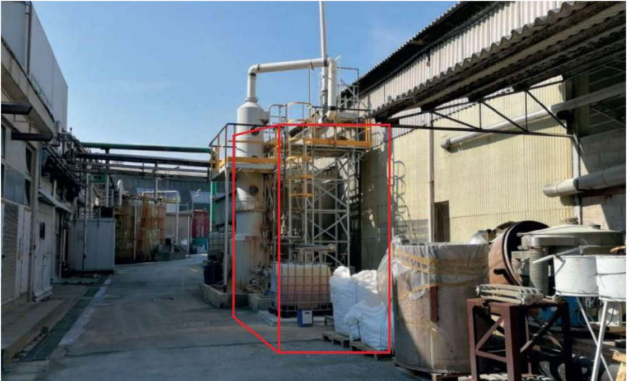
Fig. 23 - Scrubber nuovo fusore - Vista da Nord
