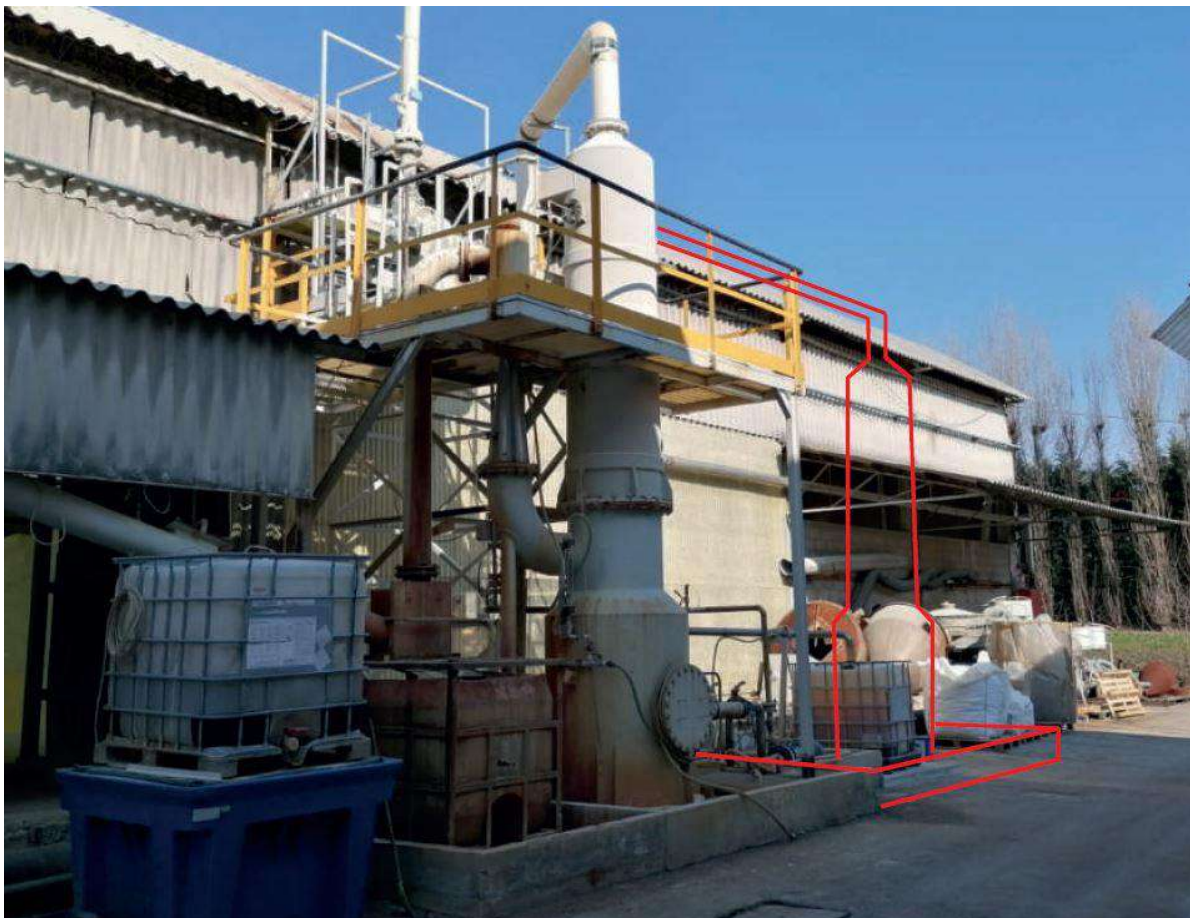
Fig. 22 - Scrubber nuovo fusore - Vista da Sud-Est
