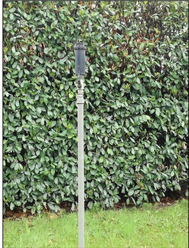
Fig. 8: Impianto bagnatura piazzale
