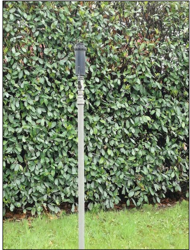
Fig. 8: Impianto bagnatura piazzale
