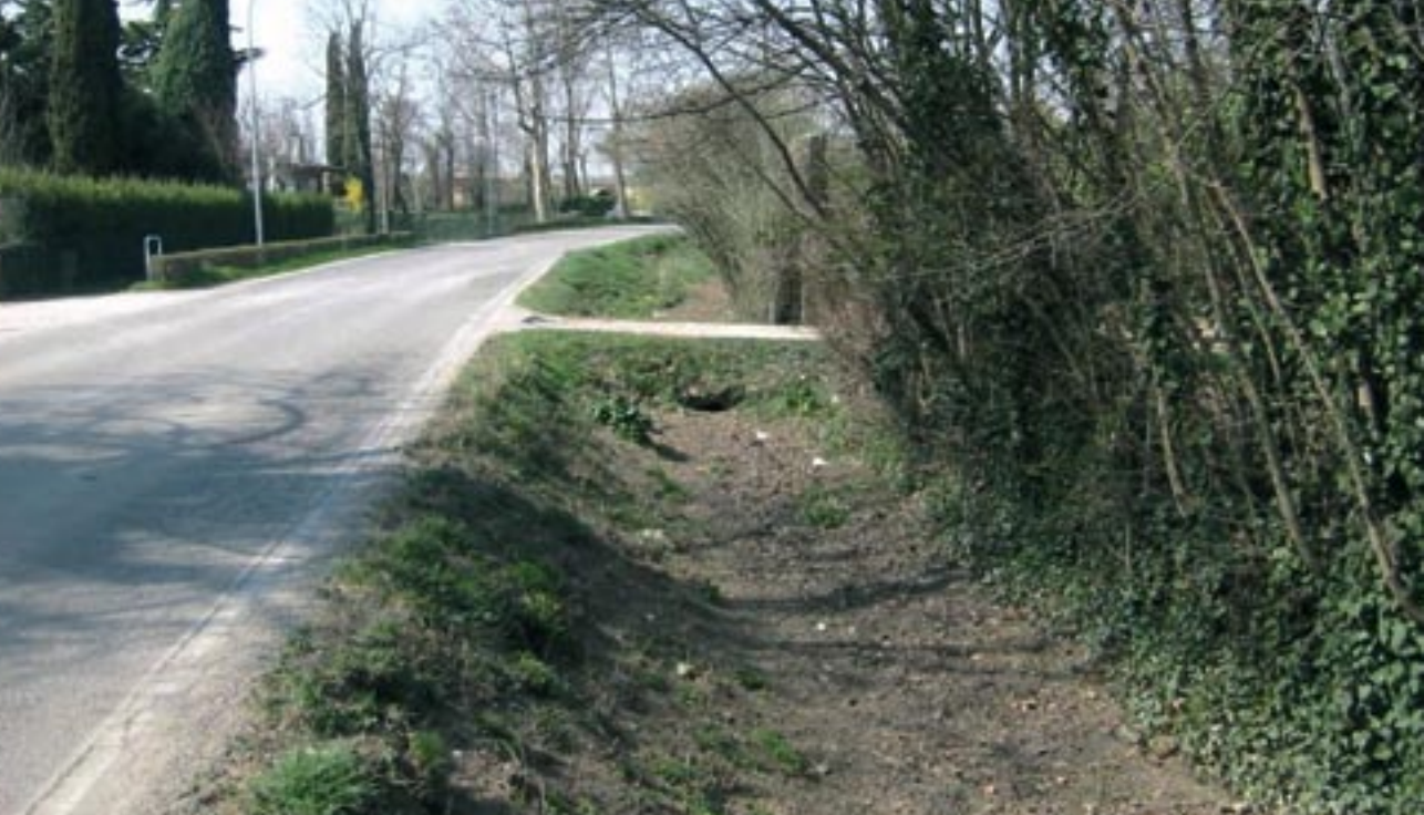
Figura 2: la mancata manutenzione di scoli e fossati causa spesso situazioni di rischio idraulico.
