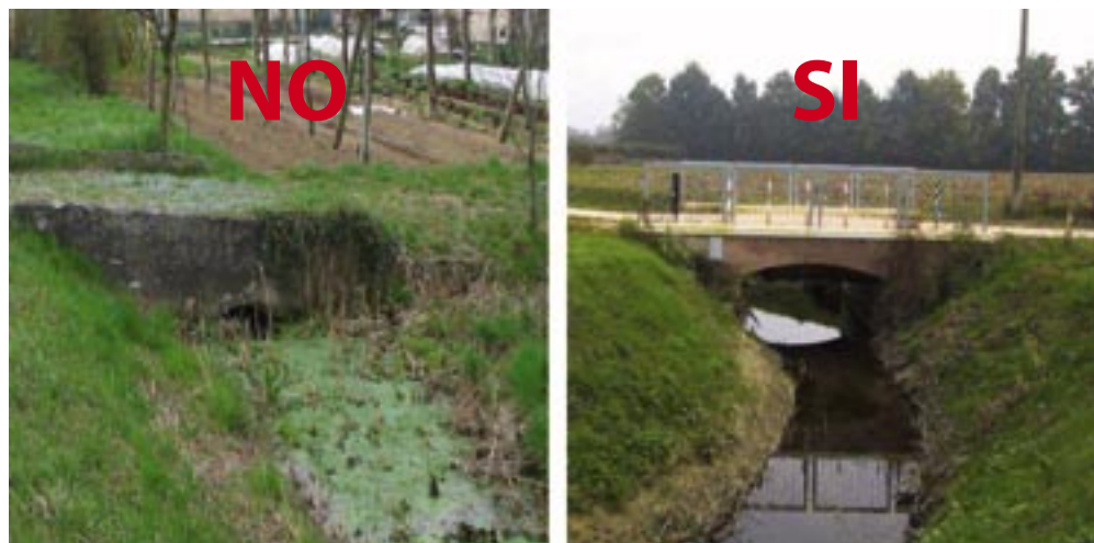
Figura 2: linee guida operative in ambito urbano. A sinistra è presentato l'approccio sbagliato, con una tubazione che limita il deflusso delle acque; a destra si evidenzia l'opera idraulica corretta, che permette il mantenimento della sezione del corso d'acqua.
